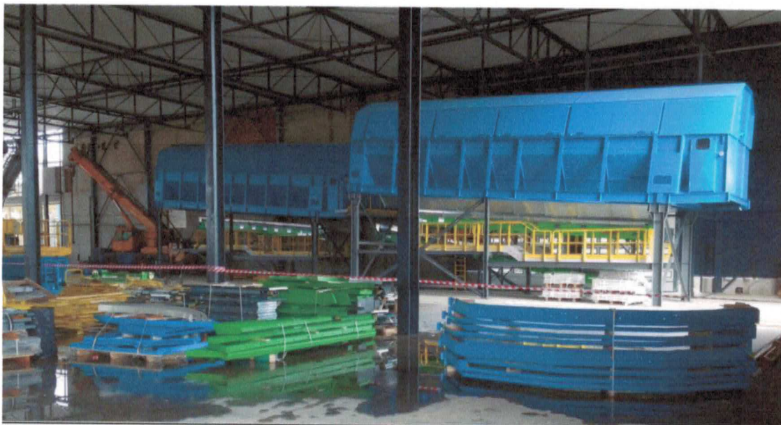
Sita bębnowe na konstrukcjach, fot. archiwum PGO Sp. z o.o.
