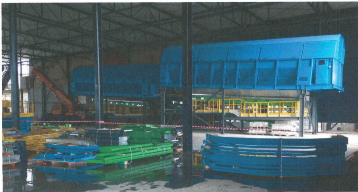
Sita bębnowe na konstrukcjach
