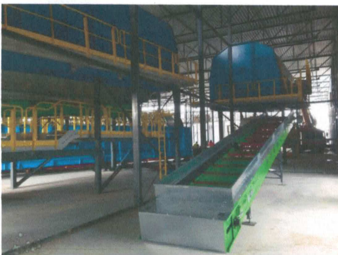
Część stacji nadawczej dla tworzyw zbieranych selektywnie, w sita bębnowe fot. archiwum PGO Sp. z o.o.
